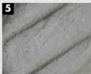
Humedecer las zonas a reparar, y aplicación de un puente de unión con KEIM Concretal-MKH a cepillo, apretando fuertemente.
