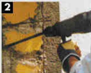
2 Descubrir la armadura oxidada
