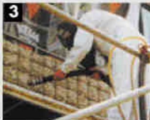
3 Limpieza de la armadura con abrasivos sólidos. Grado de desoxidación Sa 2 1/2 según DIN EN 12944-4
