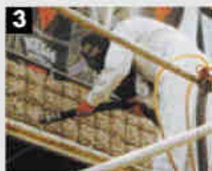
Limpieza de la armadura con abrasivos sólidos. Grado de desoxidación Sa 2 1/2 según DIN EN 12944-4
