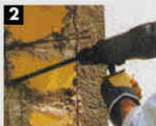
Descubrir la armadura oxidada
